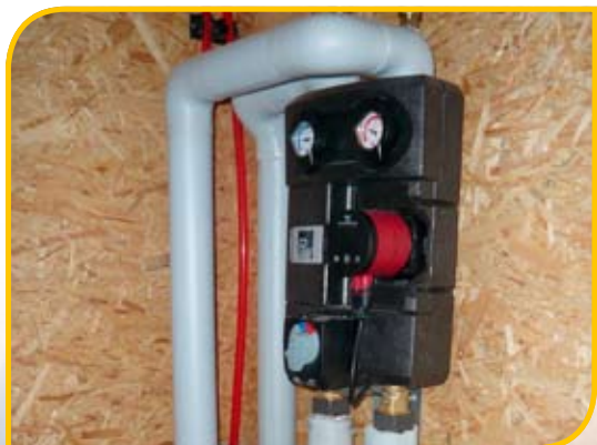
Isolation renforcée des conduites
